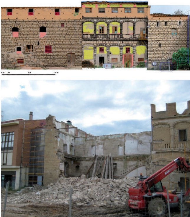
Figura 5. Plano de alzado del palacio de los Condestables en Casalarreina (La Rioja), realizado en 2006 (arriba). Estado del palacio tras su derrumbe en el año 2008.
