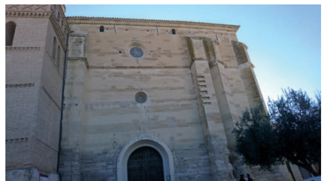
Figura 3. Estado inicial de la fachada Oeste o de ingreso de la iglesia de Leciñena
