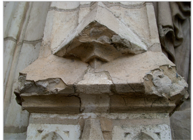
Figura 4.- Parches de cemento. Estribo derecho Portada de la Asunción.
