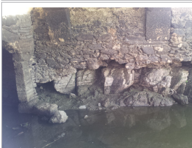
Figura 9.- Estructura de entreplanta y arranque de los arcos de la nave desde la roca. Fuente: Elaboración propia
