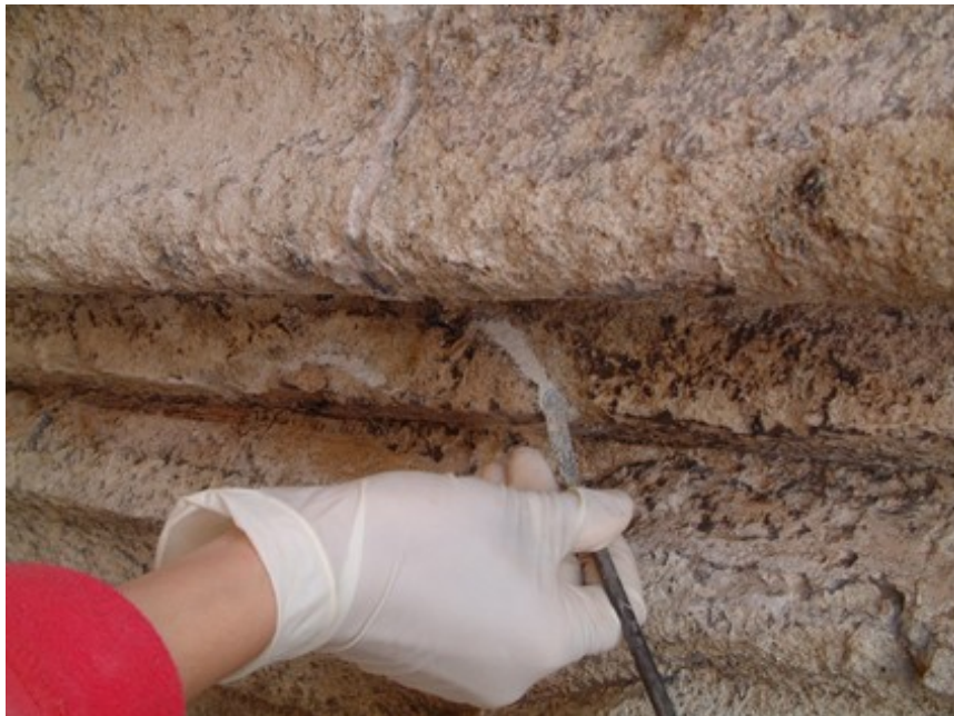
Foto 8.- Sellado de grieta durante los trabajos de mantenimiento en la portada del Nacimiento
