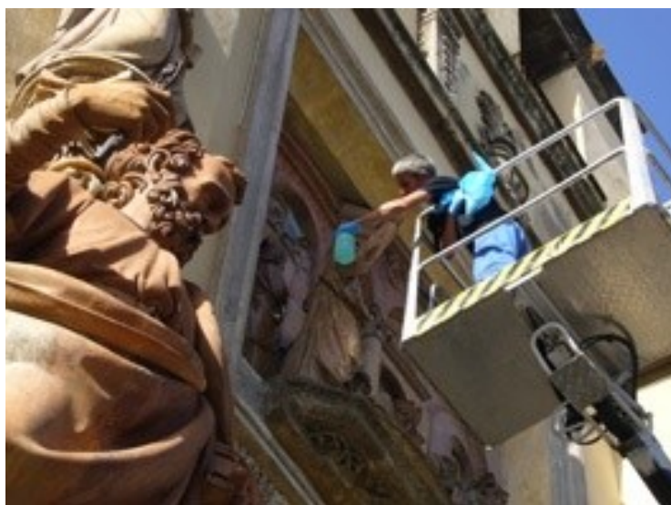
Foto 2- Grúa cesta desde la que se efectúan los trabajos de control y mantenimiento.
