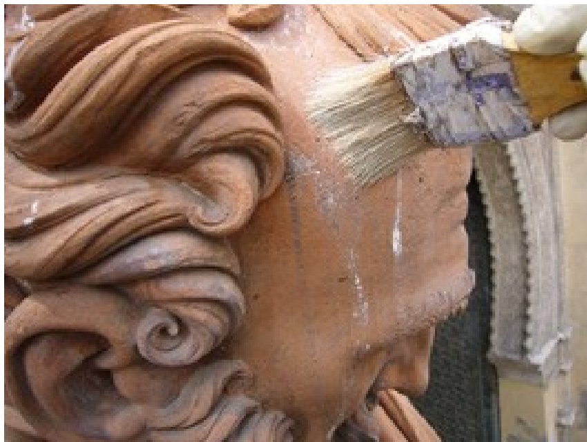
Foto 6- Limpieza de depósitos de guano en la figura de San Pedro de la Puerta del Perdón. Año 2009
