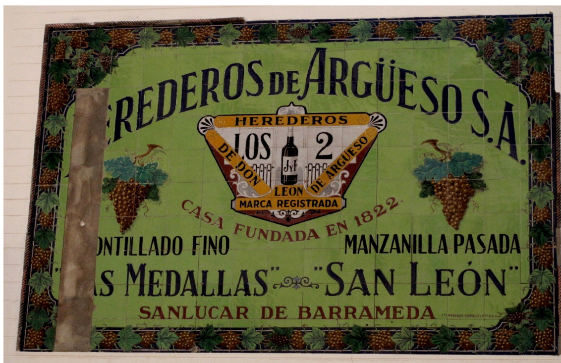
Figura 2. Destrucción intencionada de piezas en un zócalo publicitario, para acceder a la reparación de canaleta interna. Plaza de Europa, Sevilla (M. Arjonilla).
