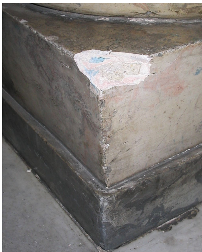
Figura 19. Rotura de la base de la columna. ©Sofía de Alfonso Alonso-Muñoyerro
