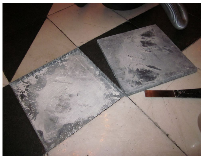
Figura 9. Baldosa de galerías que se encontraba suelta. ©Sofía de Alfonso Alonso-Muñoyerro
