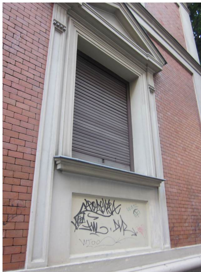
Figura 20. Vandalismo en la fachada. ©Sofía de Alfonso Alonso-Muñoyerro
