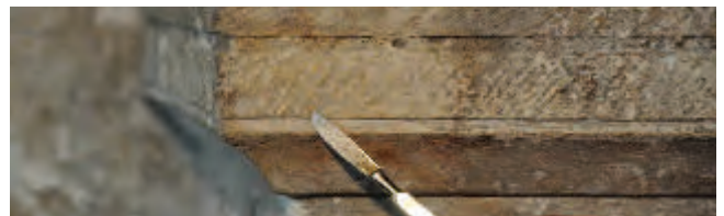
Figura 9. Aspecto de la superficie una vez aplicado el tratamiento en el pedestal de la columna de Santiago el Mayor y San Juan.
