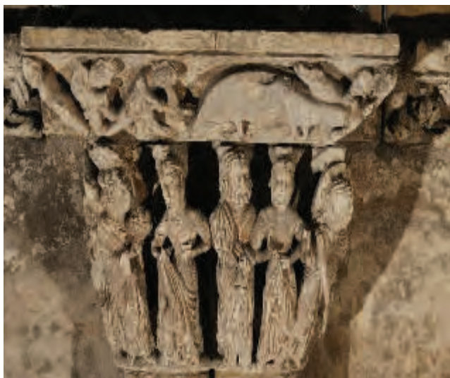
Figura 6. Pátinas incoherentes y decoloradas en el capitel decorado de la columna B, en el medio del costado norte.
