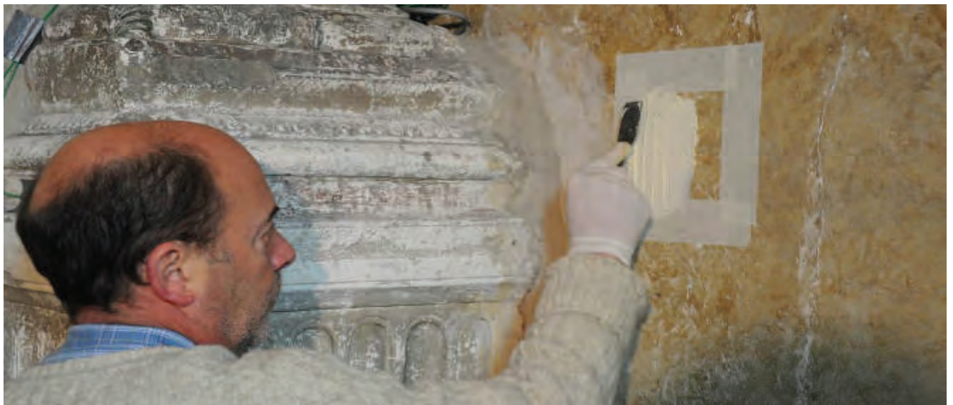
Figura 5. Aplicación de la crema "Arts Mundi" sobre el revoco de la pared sur de la Cámara Santa
