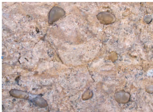
Figura 4. Alteraciones del revoco en forma de grietas, fisuras, etc
