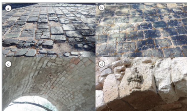
Figura 6.- a) y b) Daños y pérdidas de piezas en el embaldosado de escoria del puente “San Ignacio”. c) y d) Pérdida de juntas y daño en dovelas en el intradós de las bóvedas. Elaboración propia.
