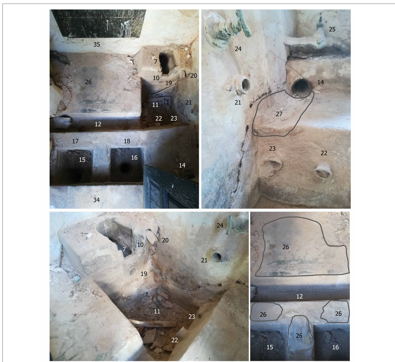
Figura 5.- Estado actual del arca de distribución. (7) Cañería nueva, (10) Compuerta, (11) Arqueta de amortiguamiento, (12) Acequia de distribución, (13) Salida de agua, (14) Rebosadero, (15) y (16) Salida de agua con arqueta, (17) y (18) Conexión entre acequia y salida de agua, (19 al 23) Canalizaciones de plomo, (24) y (25) Llaves de paso, (26) Azulejos policromados, (27) Relleno de hormigón, (34) Puerta de acceso y (35) Puerta tapiada.
