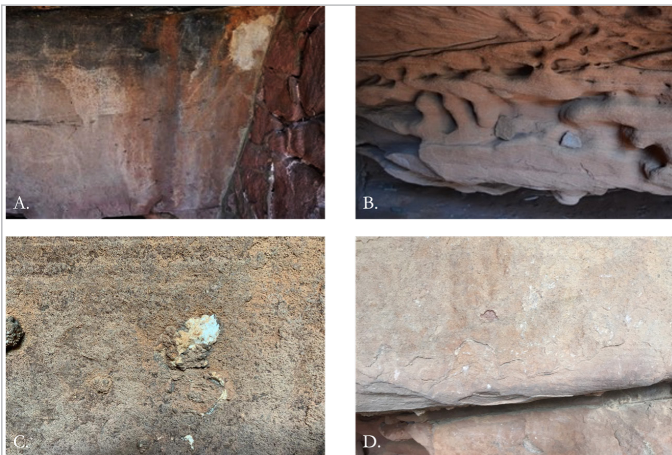
Figura 3.- Fenómenos de alteración en el abrigo de los Toros del Prado del Navazo . A). Lixiviación; B). Tafoni o erosión alveolar; C). Concreciones insolubles y sustancias detríticas; D). Agrietamientos.
