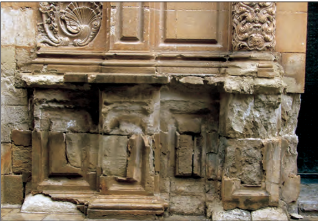
Fig. 3. Detalle de la base de sillería del cuerpo inferior del retablo pétreo. Se aprecia el acusado estado de alteración con significativos faltantes de volumen.
